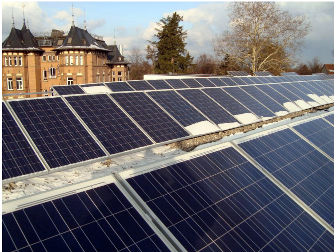
Blick auf die PV-Anlage auf dem Dach des neugebauten Bettenhauses der Evangelischen Akademie Bad Boll
