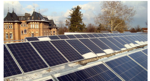
Blick auf die PV-Anlage auf dem Dach des neugebauten Bettenhaus der Evangelischen Akademie Bad Boll
